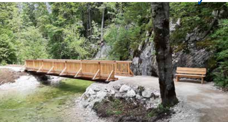
Beim Toplitzparcours wurde die völlig desolante Brücke durch eine neue ersetzt – ein Dank gilt der Bauhofmannschaft für die gelungene Arbeit.
